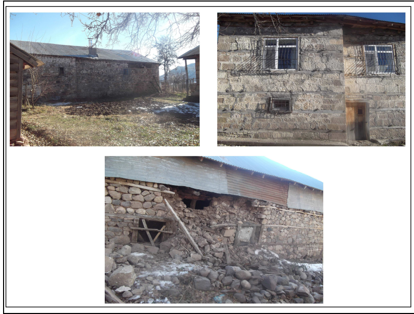
Foto 6. Deprem bölgesinde sağlam ve hasarlı taş yığma yapıları
