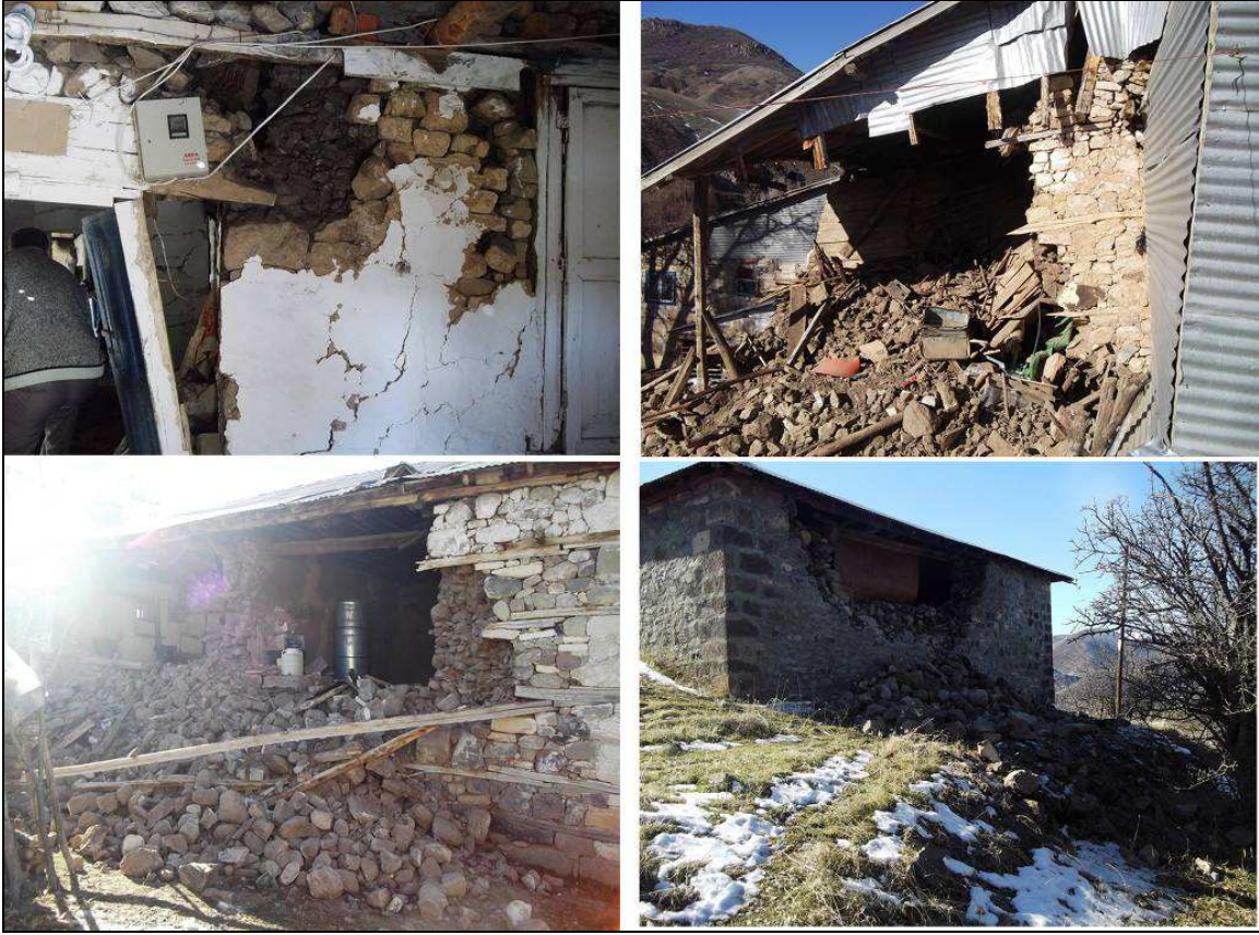
Foto 4. Açıkgüney ve Sabırtaş köylerinde ağır hasarın olduğu yapılar
