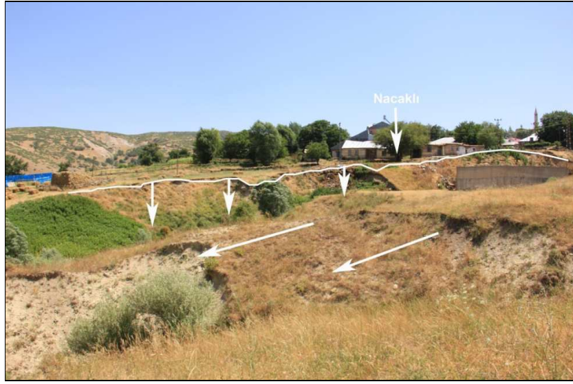
Foto 5. Nacaklı köyünde Buzluk Deresi'nin neden olduğu göçmeler yerleşme için tehlike oluşturmaktadır
