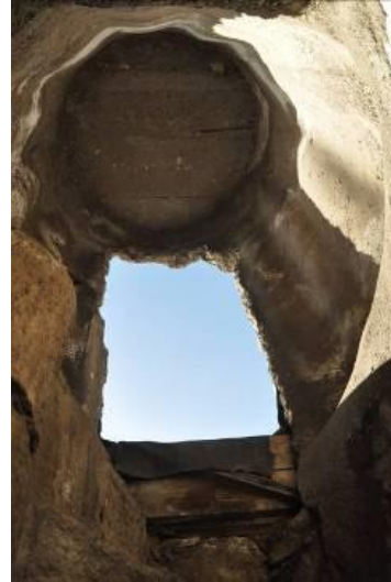
Foto. 17. Tahrip Edilen Çan Kulesi
