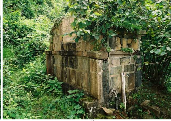
Resim 25: Şadırvan (Onarım Öncesi)
