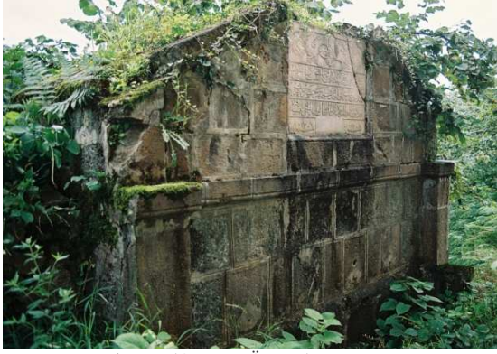
Resim 24: Şadırvan (Onarım Öncesi)
