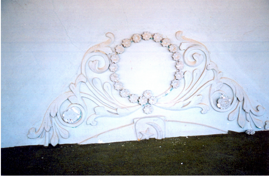
Fotoğraf 42: Söğüt Köyü Merkez Camii, kapının üzerindeki süsleme
