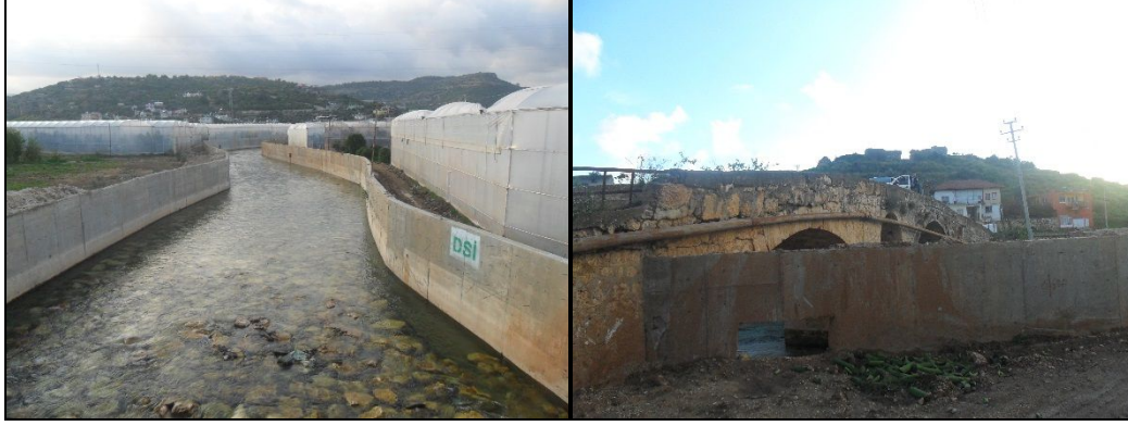
Şekil 11. Limonlu Deresi'nin aşağı çığırında yer alan DSİ tarafından yapılmış 3150 metre projeli ıslah çalışması sonucu oluşturulan beton bent (solda) ve aynı bentin tarihi taş köprüye eklendiği yer (sağda)
