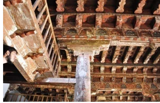
Şekil 13. Ahşap Dikmelerde Bozulma ve Bezeme Kayıpları
